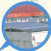
琉球ていーだ発電所
